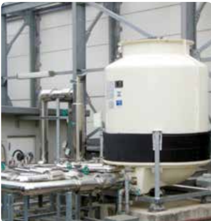
Torre de refrigeración
