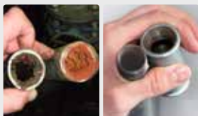
Sistema de tuberías
