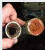
Sistema de tuberías
