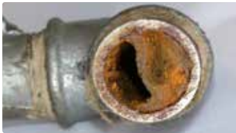
Tubería con depósitos calcáreos
