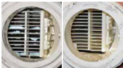
Clorador de piscina
